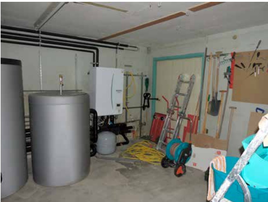
40. Ruimte in de hoek met het woonhuis met de in functie zijnde verwarming
