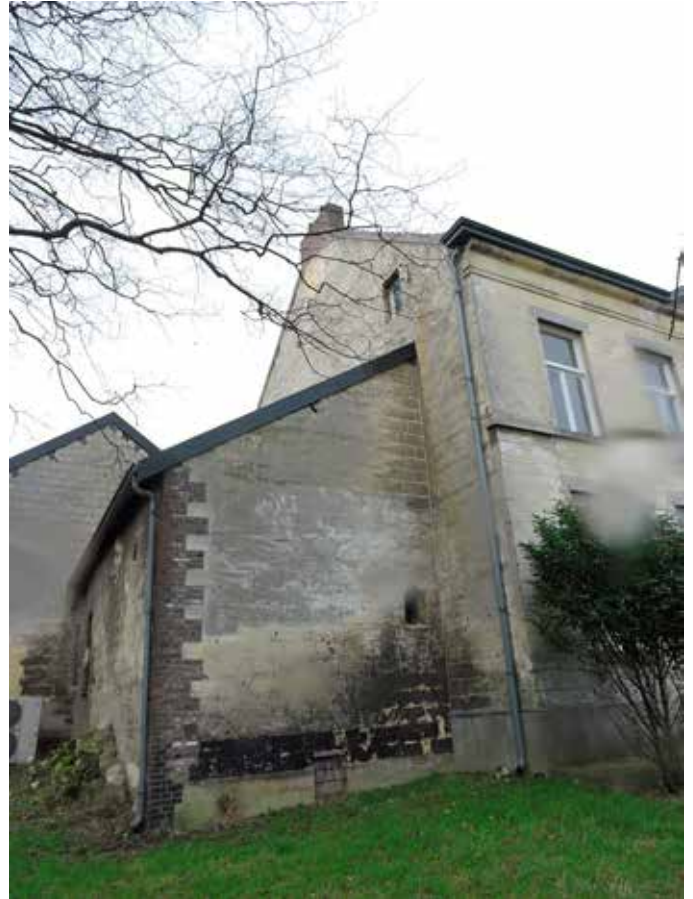
3. De hoek links van het woonhuis: dit bouwdeel is later aangebouwd. Na beschadiging van de hoek is die vervangen in baksteen
