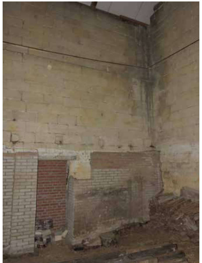
29. Een verbinding met de ruimte onder de poort is recent dichtgezet met baksteen
