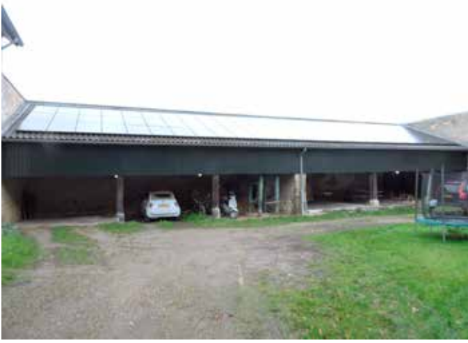
16. De open stalling met een geheel vernieuwd dak, en belegd met zonnepanelen
