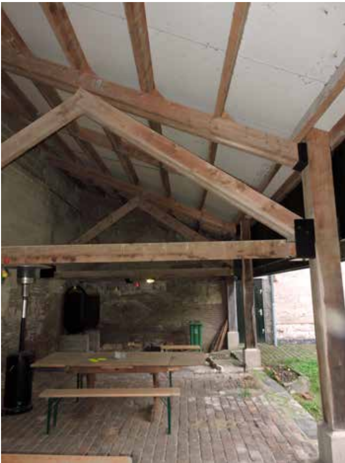
30. De spanten van de open stalling zijn rond 1970 vernieuwd, het dakvlak recent
